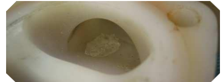
照片4 阀门内部有气泡产生
