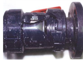
照片2 阀门破损
